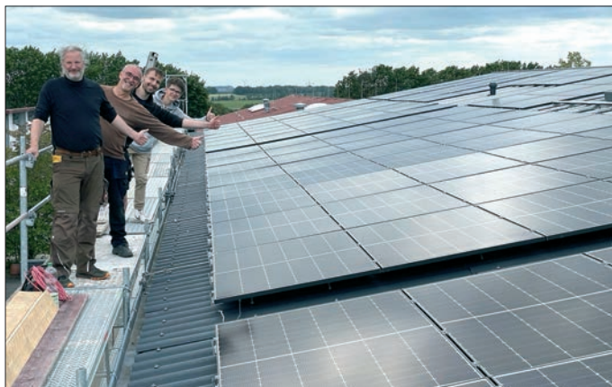
Freude über die zweite Photovoltaik-Anlage bei den Mitgliedern von WirMachenEnergie eG. Foto: Sebastian Wittig
