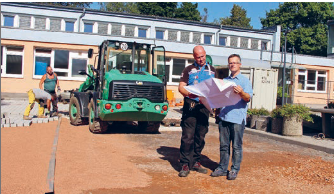
Bauamtsleiter Andre Stefan stimmt sich mit dem Hausmeister des Förderschulenzentrums, Michael Frenzel, zu Einzelheiten des Bauablaufs ab. Foto: rs.
